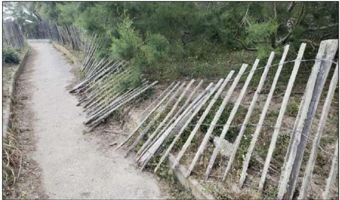
Les ganivelles en bois nécessitent d'être remplacées le plus rapidement possible. PHOTOS A.-F.I.
